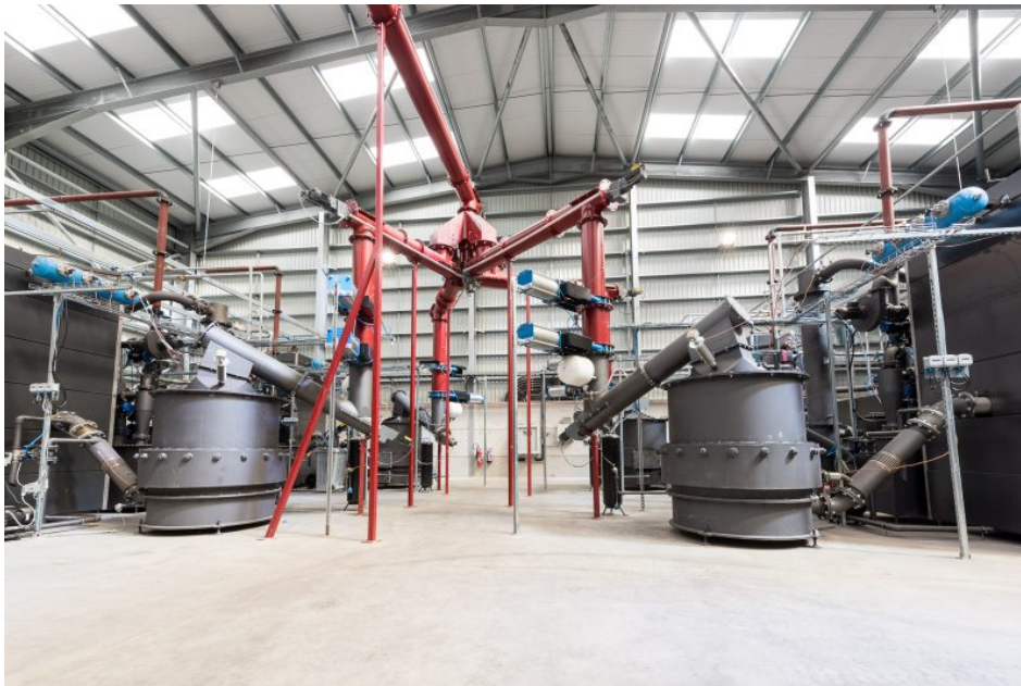
Holzvergasungsanlage (ein Megawatt elektr.) von Bioenergie Wegscheid (Bild: L'Engineers).
