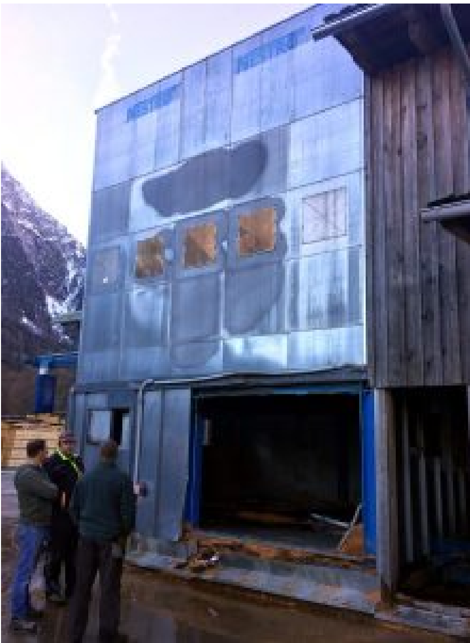
Brandschaden am vorherigen Filter (Bild: Nestro).
