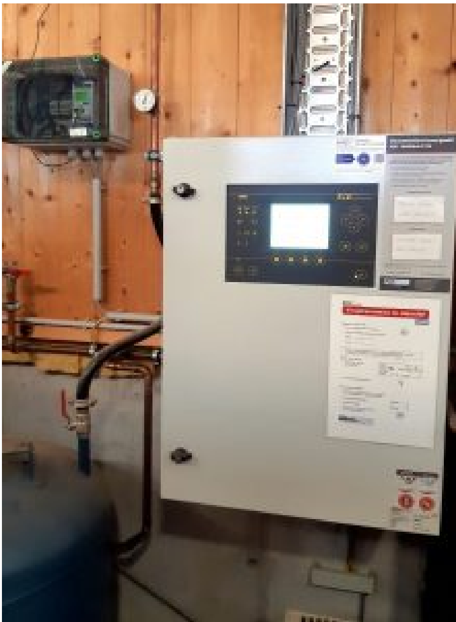
Funktionsmeldezentrale des Funkenlöschsystems (Bild: Nestro).
