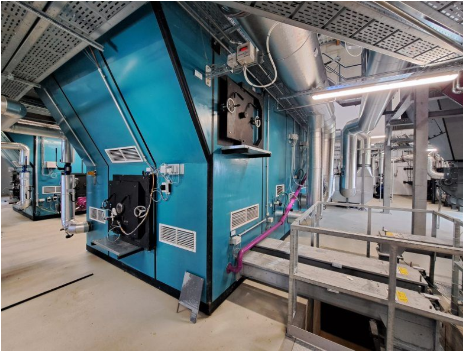
Anlage zur Fernwärmeversorgung in der ungarischen Stadt Kaposvar mit zwei 7500-Kilowatt-Heißwasserkesselanlagen (Bild: Polytechnik).
