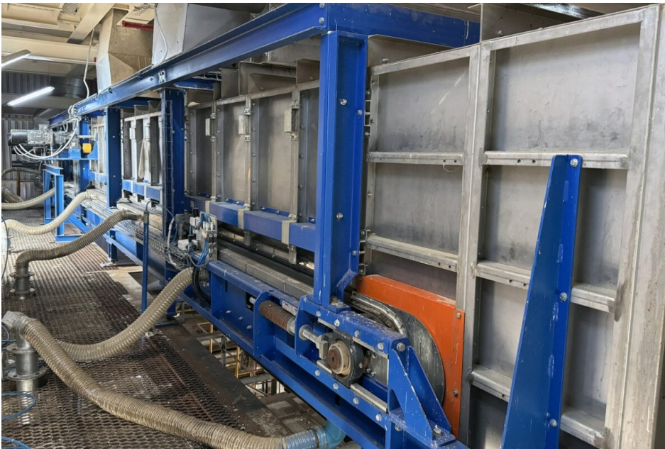
Dryer Discharge Conveyor (DDC) in der MDF-Linie 1 von Wisewoods (Bild: Dieffenbacher).
