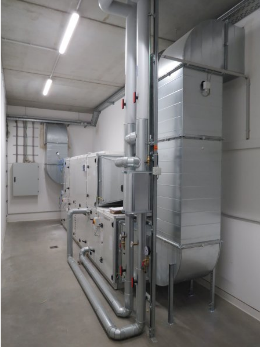
Gerätezentrale. Bild: Nestro
