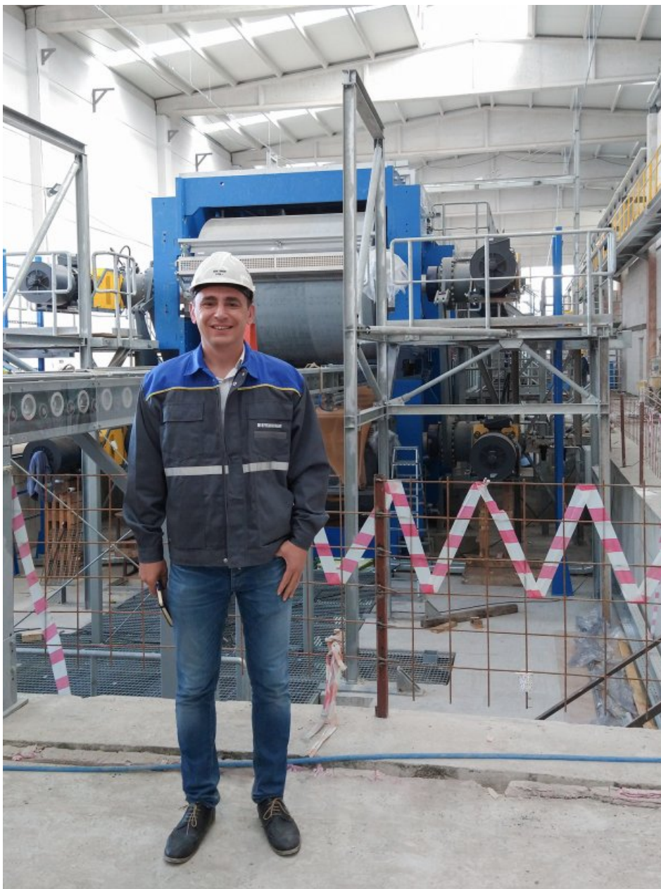
Işık Zorcu vor der im Bau befindlichen Anlage im neuen MDF-Werk von Camsan Ordu in Ordu, Türkei (Bild: Dieffenbacher).
