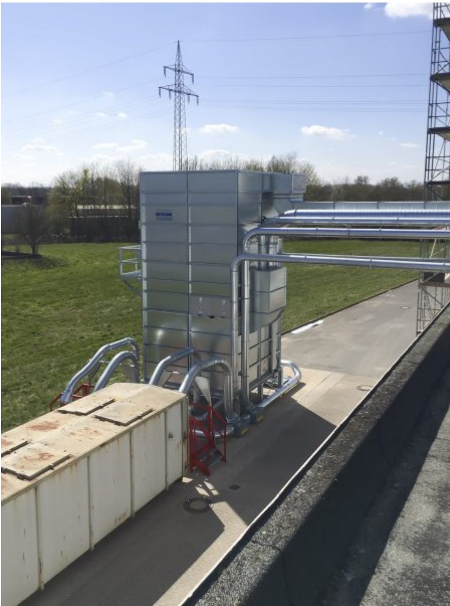
Die Filteranlage benötigt lediglich 16 Quadratmeter Stellfläche (Bild: Höcker Polytechnik).
