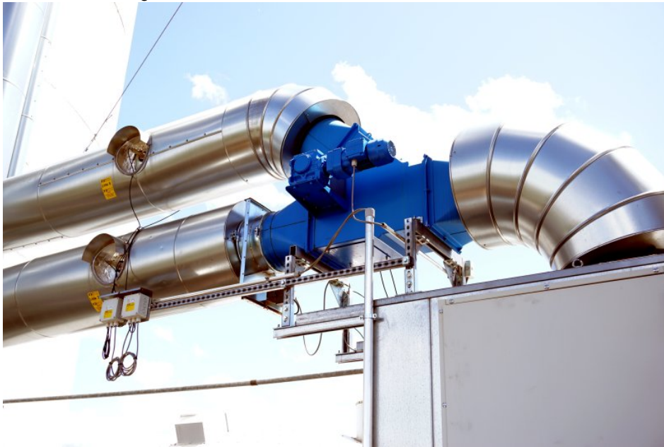
Automatische Druckrohrweiche und Containerstation (Bild: Nestro).
